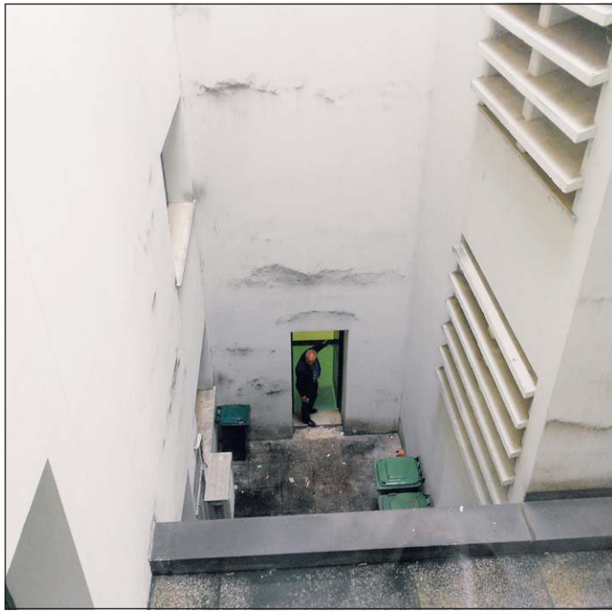
Il condotto ripulito dai rifiuti
